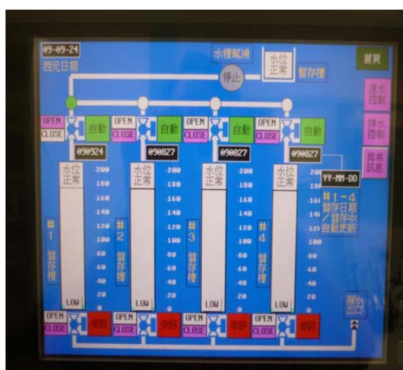
放射性廢水監測設備
